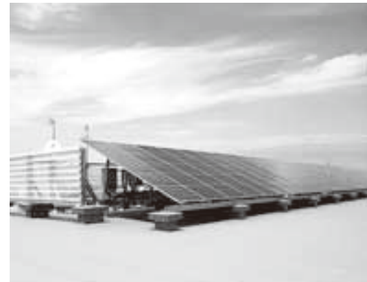
美里中学校「太陽光パネル」
