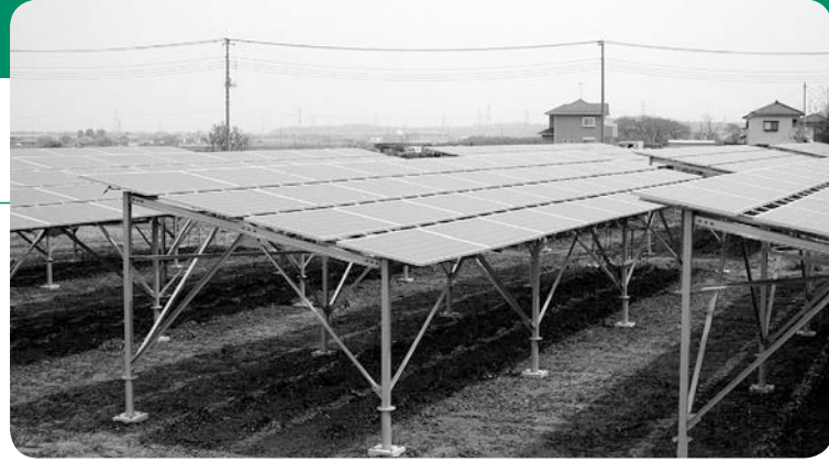
太陽光発電施設
