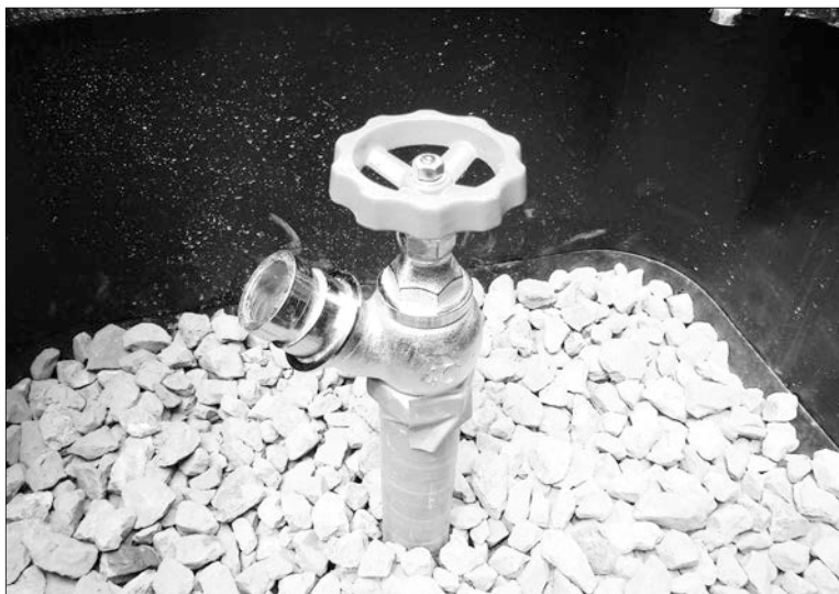
口径40ミリの消火栓
